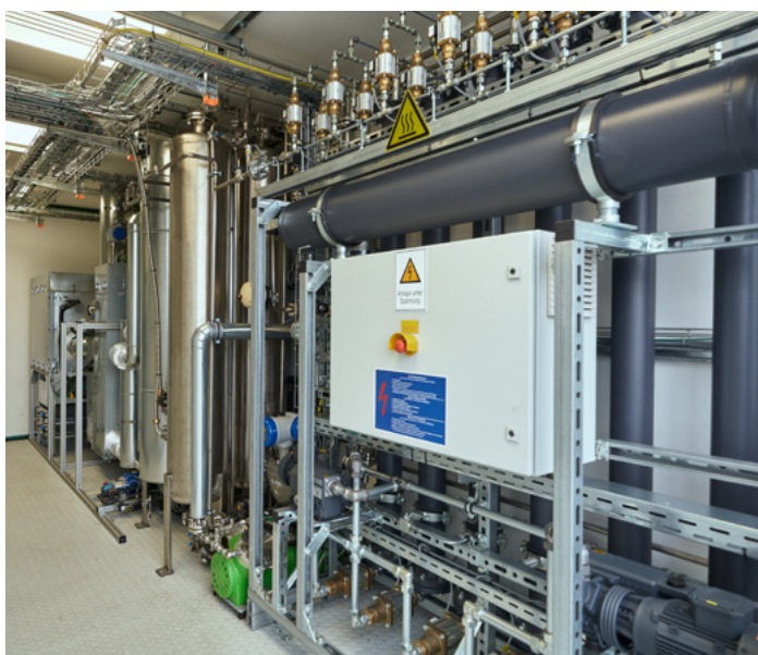
Die Anlage kann in einen Elektrolysemodus wechseln, um aus elektrischer Energie Wasserstoff oder Methan zu erzeugen.
