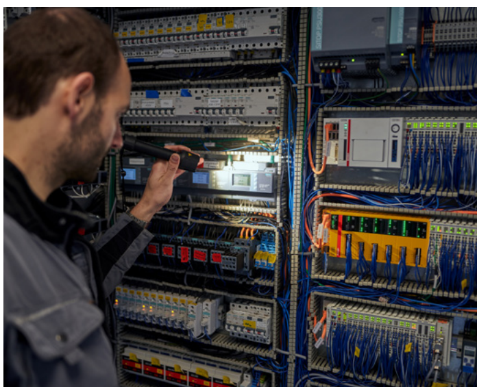
Bei der elektrischen Ausstattung seiner Anlagen setzt Reverion unter anderem auf HELUKABEL.
