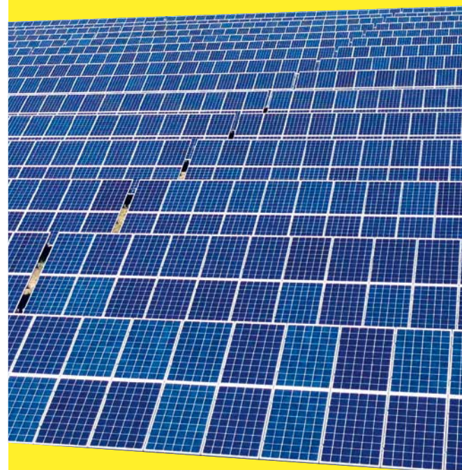
Über 700 Kilometer Kabel sind in der Photovoltaikanlage im weißrussischen Bragin verbaut.
